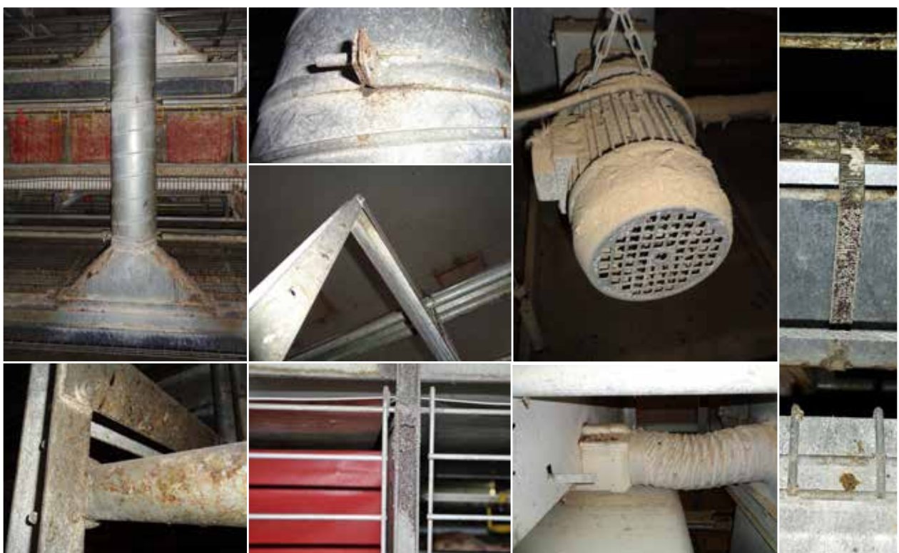
Figuur 4: Voorbeelden van plaatsen die extra aandacht vergen bij het reinigen van de stal zoals mestbandbeluchting, motors, buizen, stellingen en kabelbinders
