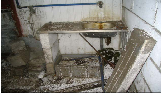
Stal 2 Grondwaterwinning + defecte afvoer
