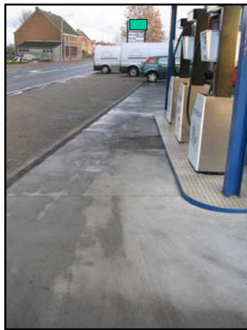
tankvloer niet OK (rooster te kort bij pompen)
