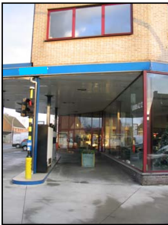
tankvloer niet OK (benzine onder luifel)
